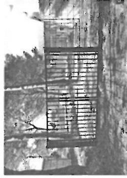
Accès à l'arrière du gymnase bloqué
