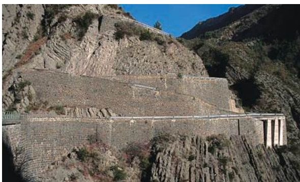
La nature du substrat des versants induit une forte sensibilité aux travaux routiers répétés et délicats.
