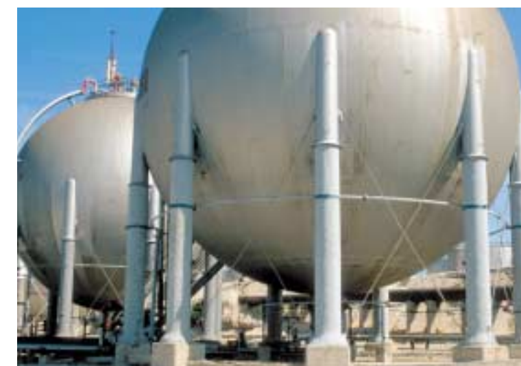
Ancrage des sphères de stockage au sol (BP Lavéra) - [Photo : R. Lengereau]
