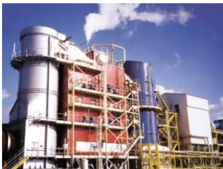
Usine d'incinération de déchets industriels dangereux de Solamat Merex (Fos-sur-Mer)
