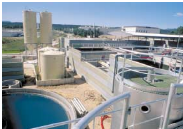
Station d'épuration industrielle à Rousset (OTV) - [Photo : R. Lengereau]
