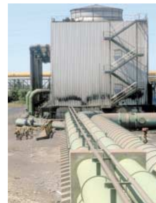
Tours aérofrigorantes de Sollac - Fos-sur-Mer - [Photo : R. Lengereau]
