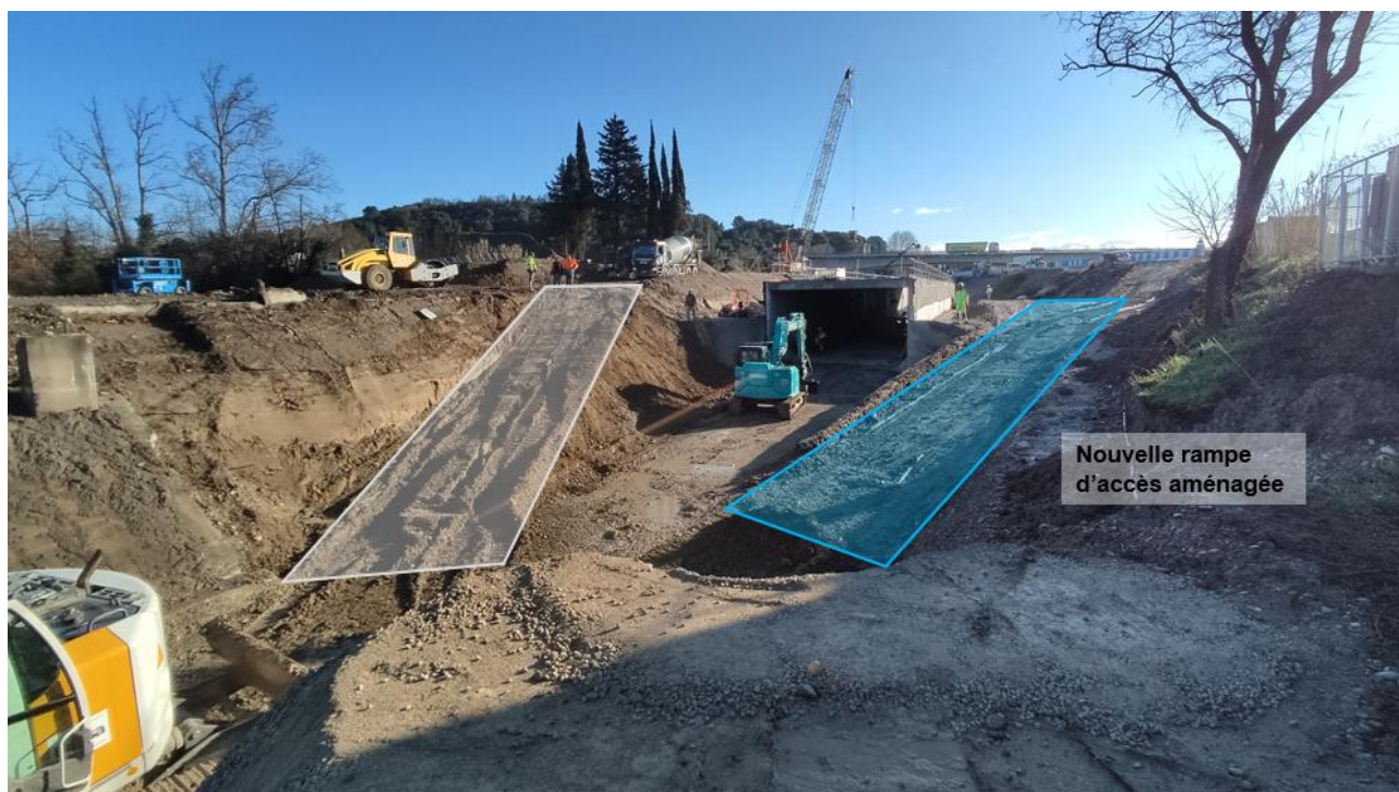
Figure 17 : Prise de vue du basculement potentiel de la rampe amont, située en aval de la galerie créée sous le futur giratoire
