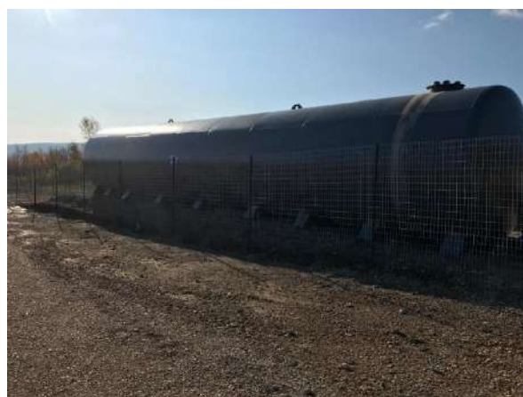
Figure 20 : Exemple d'une citerne en dur 120m³ (Source : EDF Renouvelables France)
