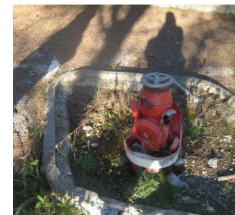
Borne incendie présente sur le site
