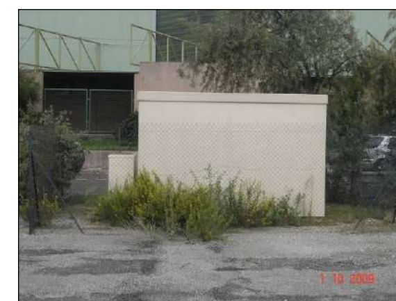
Transformateur sur site alimenté depuis le pylône HTA le long de l'Avenue d'Arménie
