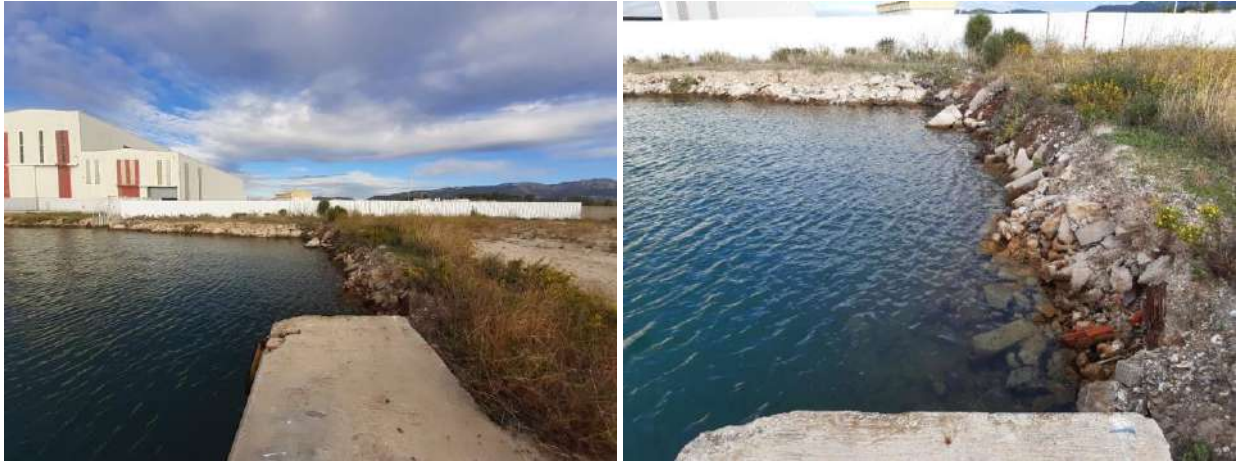
Figure 11 : Talus en fond de darse - Photos prises lors de notre visite sur site en octobre 2022)
