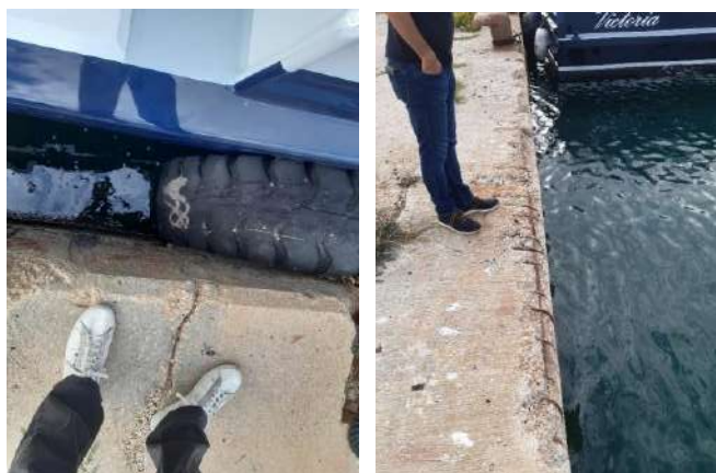
Figure 10 : Epaufrures et fissuration avec fers apparents - Photos prises lors de notre visite sur site en octobre 2022
