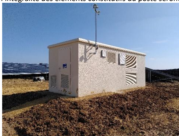
Exemple de postes de transformation
